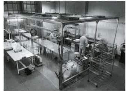
半導体用クリーン配管製作等のクリーンブース
